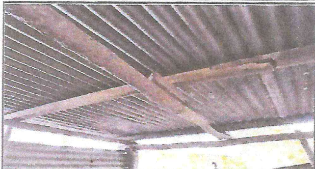
Foto 1: Cocina con estructura de madera podrida y en mal estado.
