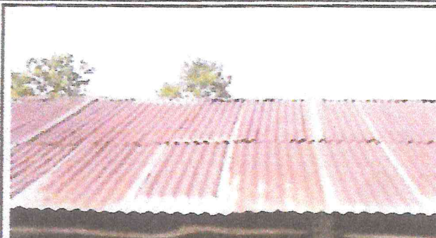
Foto 2: Techado de la cocina con lámina en mal estado
